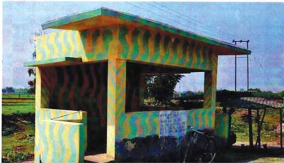
सीमा क्षेत्र विकास कार्यक्रम के अन्तर्गत अन्तर्राष्ट्रीय भू-सीमा पर वर्षा आश्रय का निर्माण
