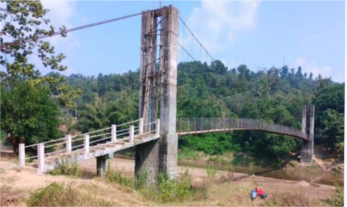
ब्लॉक-बाघमारा, जिला - साउथ गारो हिल्स (मेघालय) में रोम्पा नदी के ऊपर गिटिंगरे में, सस्पेंशन फुट ब्रिज का निर्माण। निर्माण कार्य पूरा होने का वर्ष: 2023-24
